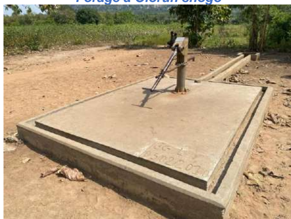
Pompe manuelle à Davi-sogo
